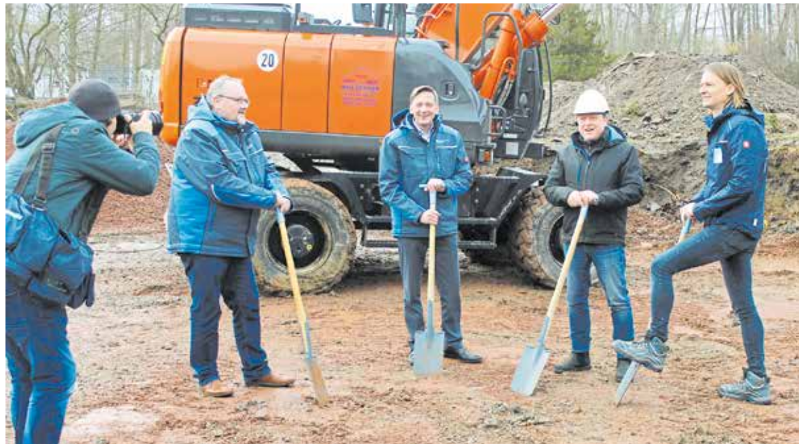
Offizieller Baustart mit Pressebegleitung am 3. Februar: Der erste offizielle Spatenstich wird von Präsident Frank Wagner vorgenommen. Foto: Romy Weisbach
