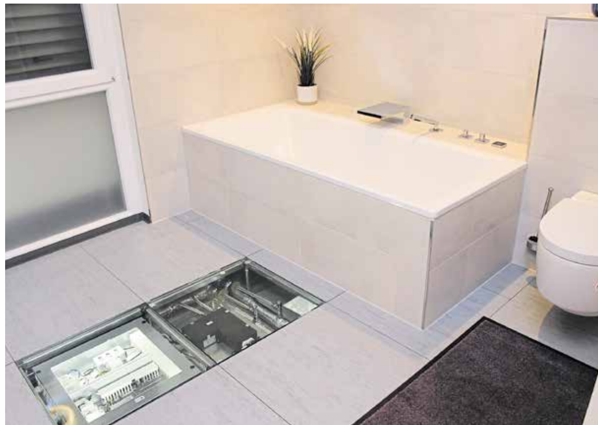
Ein Doppelfußboden macht das komplexe Innenleben des E-Hauses sichtbar. Im Bad laufen unter dem Boden, abgedeckt mit einer Glasplatte, Wasser und Elektrik zusammen. Foto: Romy Weisbach
